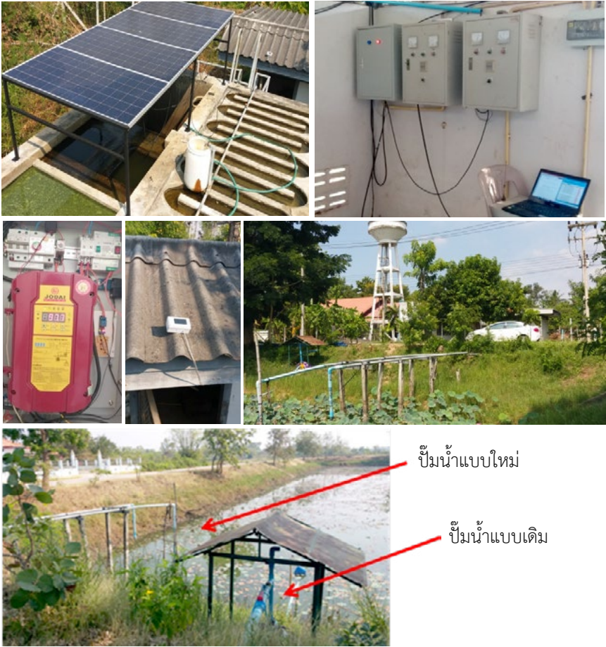
การติดตั้งระบบสูบน้ำโซลาเซลล์ ร่วมกับระบบสูบน้ำเดิม ณ บ้านโนนกราด หมู่ 1 ตำบลหนองสูงเหล็ก อําเภอเฉลิมพระเกียรติ จังหวัดนครราชสีมา
